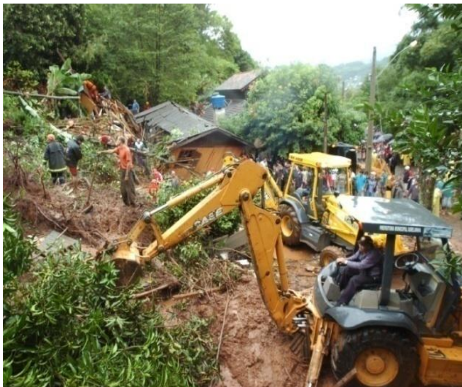
Deslizamento de encosta 23/04/2011 com a morte de 7 pessoas
